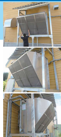
冷水コイル設置例
